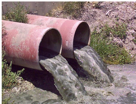
Fig.16. Contaminación por aguas residuales, fuente Google.
