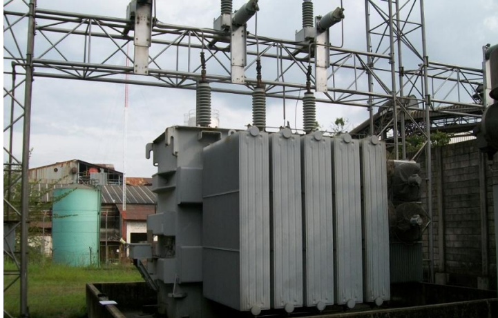
Figura 23. Transformador trifásico de 33 MVA Waukesha, vista trasera
