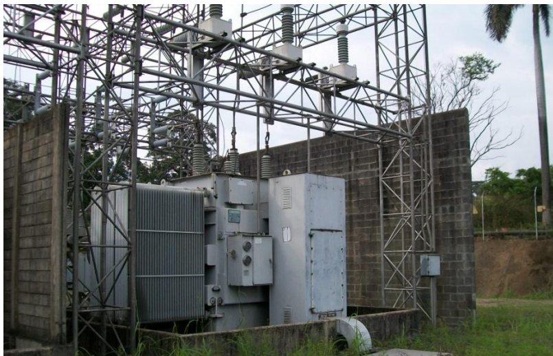
Figura 24. Transformador trifásico de 33 MVA Waukesha, vista frontal
